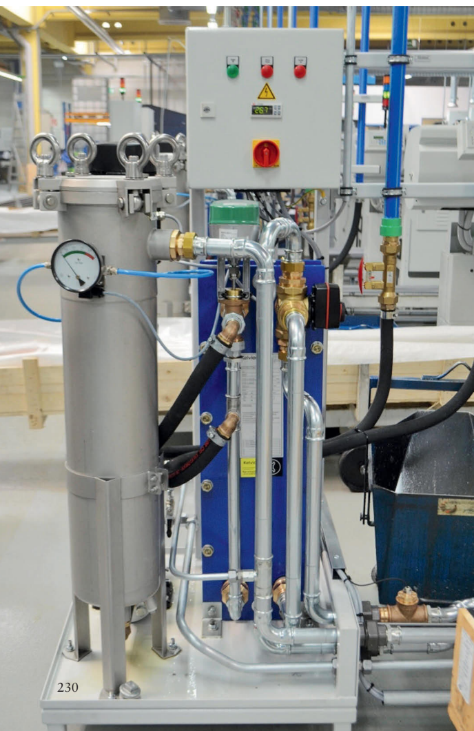
Kühlmittelaufbereitung mit Rückkühlung über Plattenwärmetauscher.
