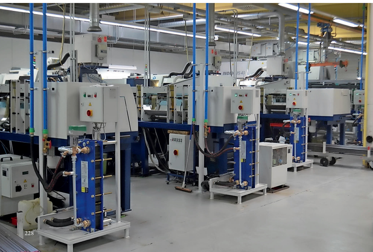
Auf dem Foto zu sehen: Bearbeitungszentren mit Kühlmittelaufbereitung und Plattenwärmetauschern zur Rückkühlung. Bild: HSS
